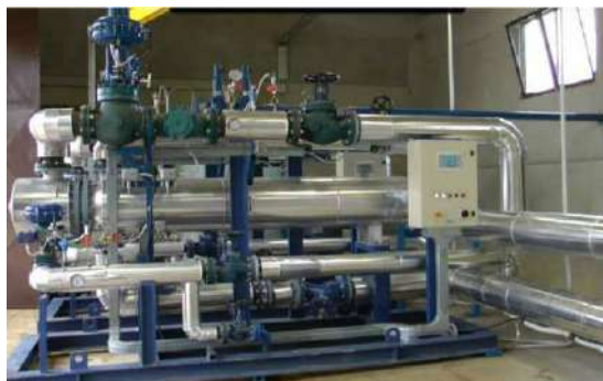
Figura 8 - Centrale di scambio secondario presso l'abitato di Monteverdi Marittimo
